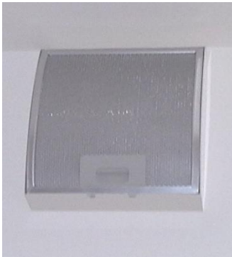
Abbilddung Abluft: Abluftventil in Küchen mit herausnehmbaren Filter zur Reinigung
